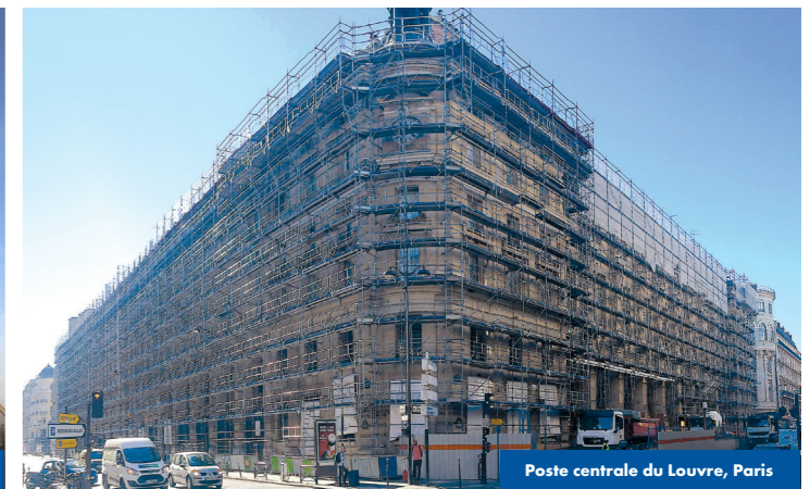
Poste centrale du Louvre, Paris
